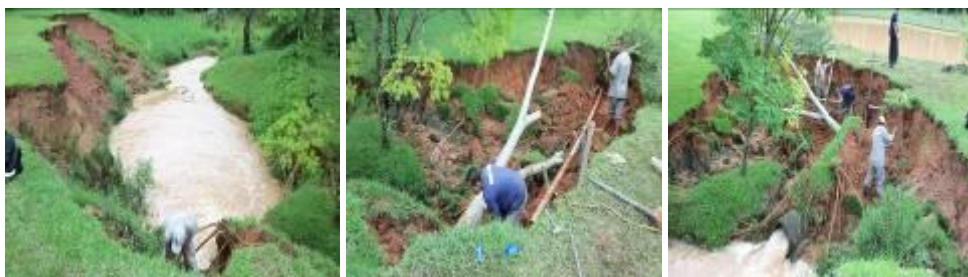
Erosão e rompimento de tubulação dos poços 06 e 08
