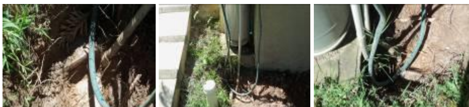
Regularização, filtro antes do hidrômetro
