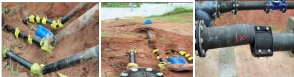
Rompimento da tubulação Sabesp, apoio e acompanhamento
