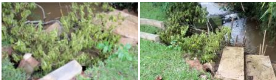
Erosão na escada hidráulica do lago
