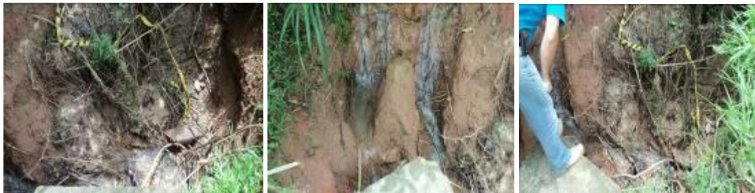
Erosões na entrada da caixa pluvial Q19
