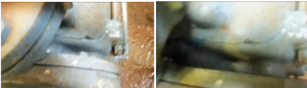
Vazamento bomba de recalque, subst. do equipamento
