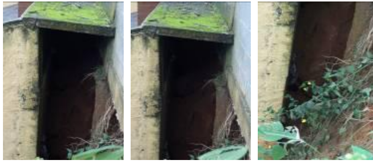
Risco de queda de muro Q18 (Edícula já embargada)
