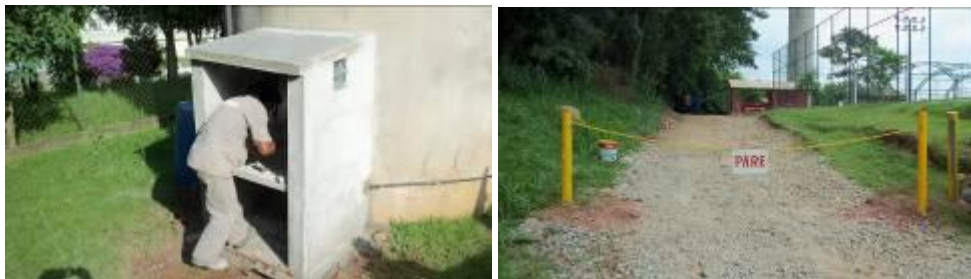
Nova caixa da repetidora
